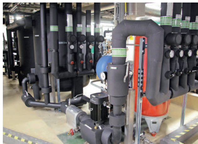
Mit der Aufspaltung eines Kühlwasserstrangs in vier einzelne, regelbare Versorgungsleitungen konnte eine effizientere Betriebsweise erreicht werden.
