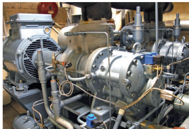
Die Kältekapazität einer neueren, bereits installierten Kälteanlage mit zwei Kompressoren reicht aus, um auch die Arbeit einer älteren, ineffizienteren Maschine zu übernehmen.
