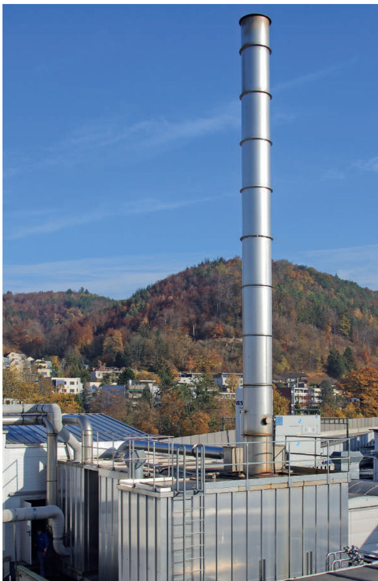
Mit der Abluft aus der katalytischen Nachverbrennung, welche zur Reinigung von mit Lösungsmitteln belasteter Luft eingesetzt wird, könnte eine Wärmerückgewinnung zur Bereitstellung von Heizungswasser betrieben werden.
